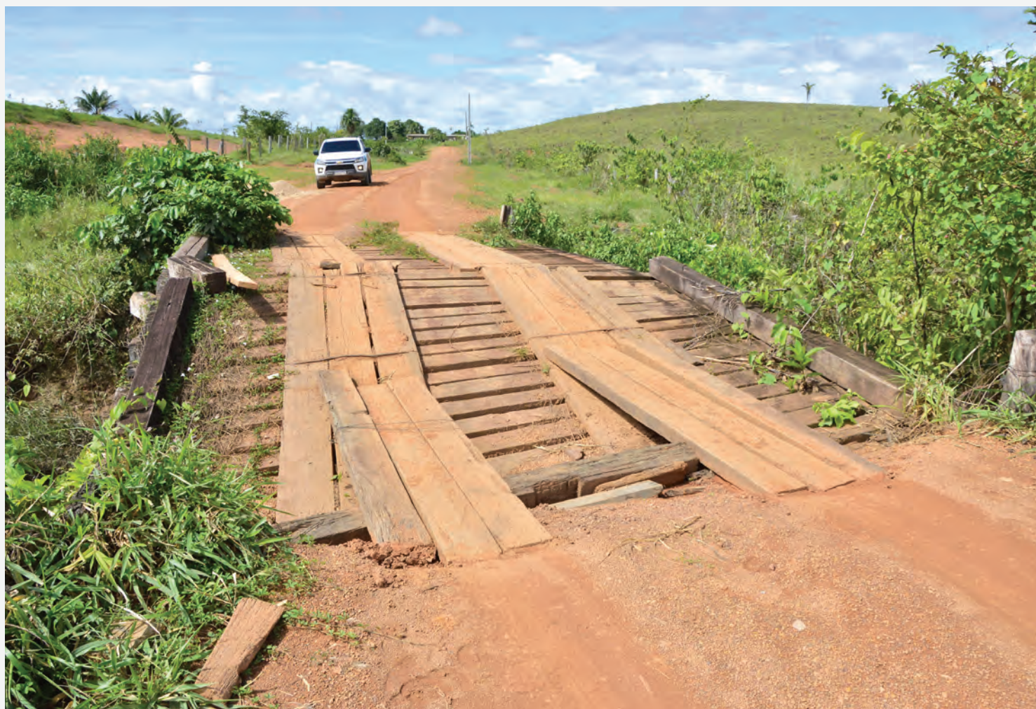
(Ponte colapsada na vicinal 23, Mucajaí)
