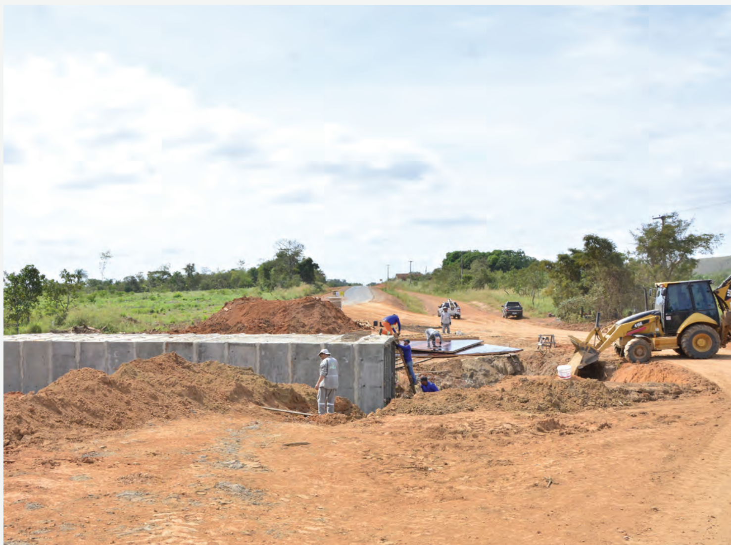
(Galeria em fase de construção na RR-342, região do Taiano, Alto Alegre)
