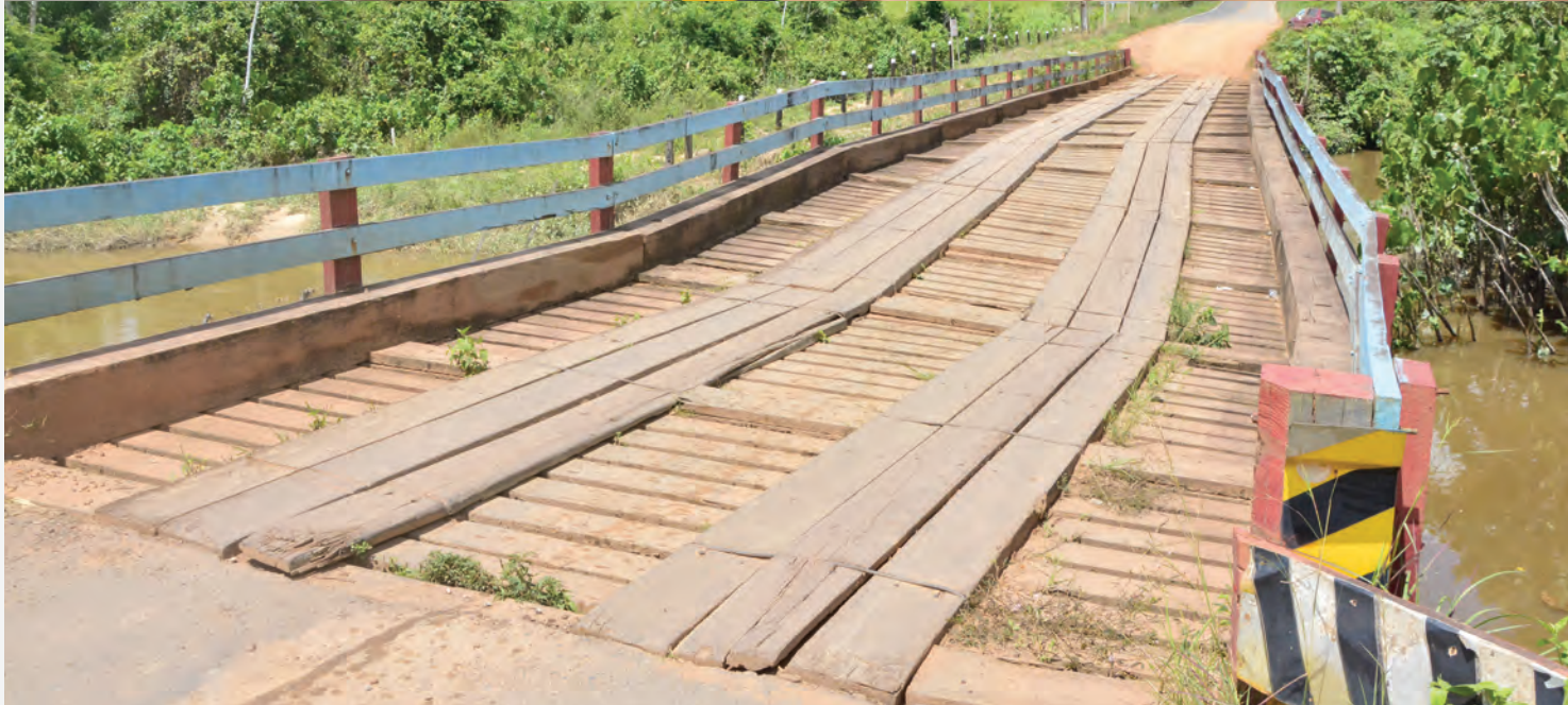
(Nova ponte construída sobre o igarapé Grotão, na RR-325, e na segunda imagem a situação colapsada da infraestrutura anterior)
