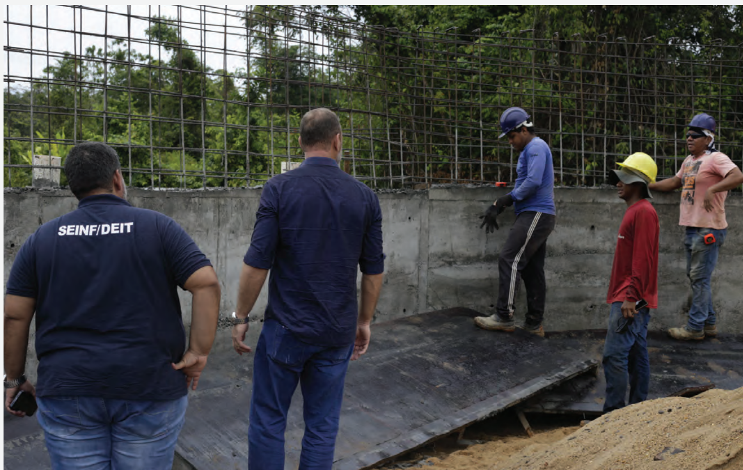
(Equipe do DEIT durante fiscalização de ponte localizada na RR-205 região do Paredão, Alto Alegre)
